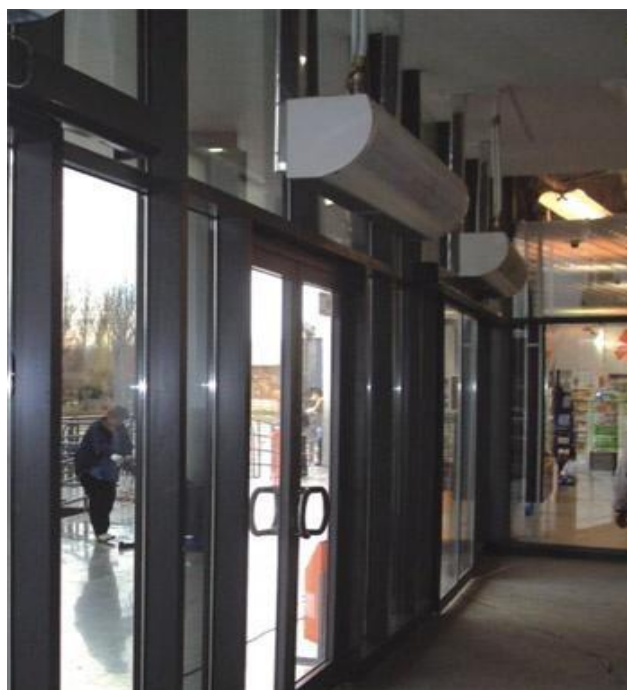
Рисунок 26 – Горизонтальные тепловые завесы над входными дверями
