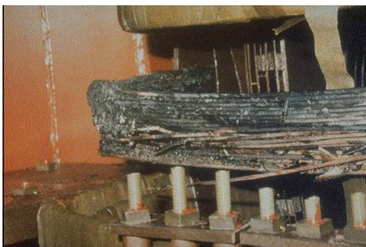
Рисунок 1 – Сгоревший силовой трансформатор компании PublicServiceElectricandGasCompany в Нью Джерси во время супербури в марте 1989 г.
